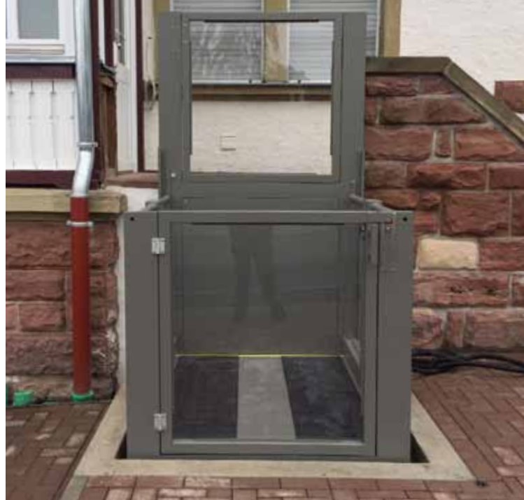
Installation dans une fosse avec une porte sur la plateforme
