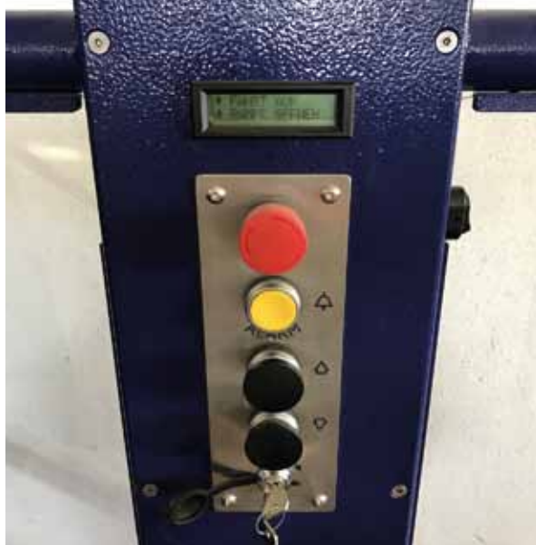
Contrôle sur la plateforme avec bouton d'arrêt et d'alarme ainsi que une indication digitale de l'état de la plateforme
